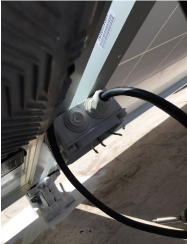
Caja que protege la conexión del microinversor, con el cable que va a la corriente de la casa
